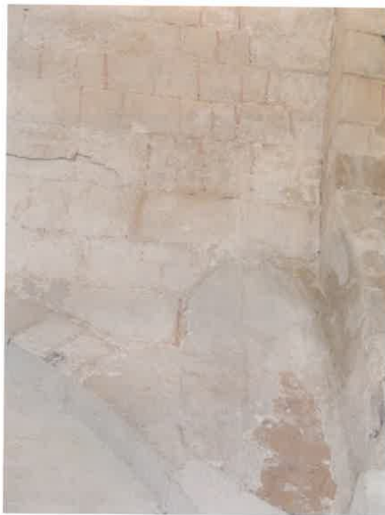
Faux joints peints de la même époque que le cavalier
